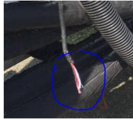
Abbildung 6.1: Durchtrennte Signalleitung von einem Tauchfühler
