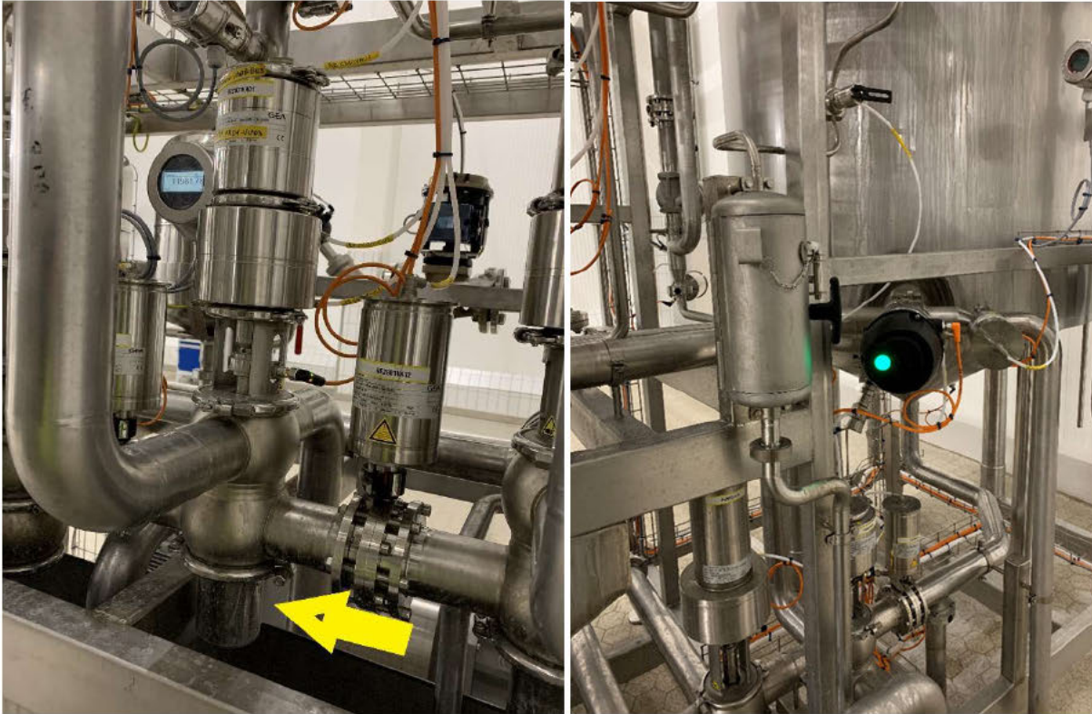
Abbildung 20 links: Ventil RE2801 VA01 des Rahmerhitzers mit Auslauf zum Gully (gelb). (Eigene Aufnahme, 2022)
