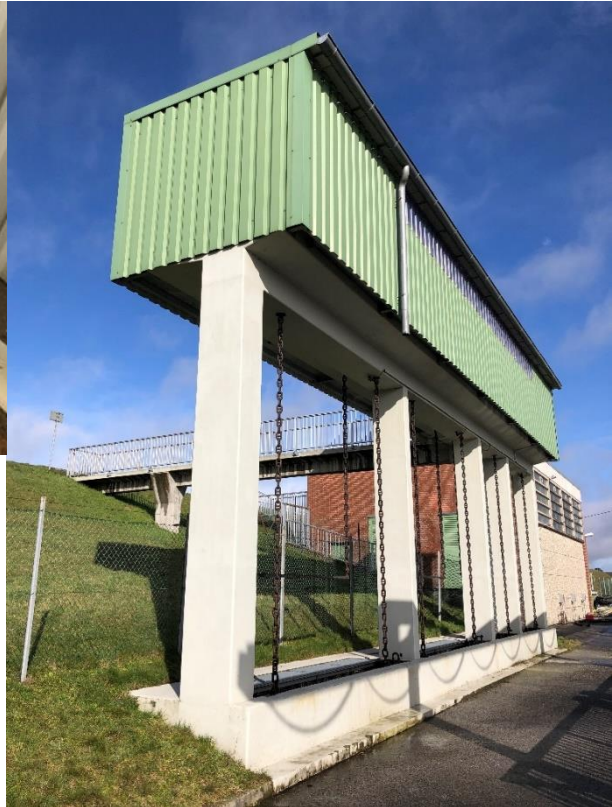
Abbildung 5: Drosselschütze und Steuerstand des Netzedükers (Brößler, eigene Aufnahme, 2023)
