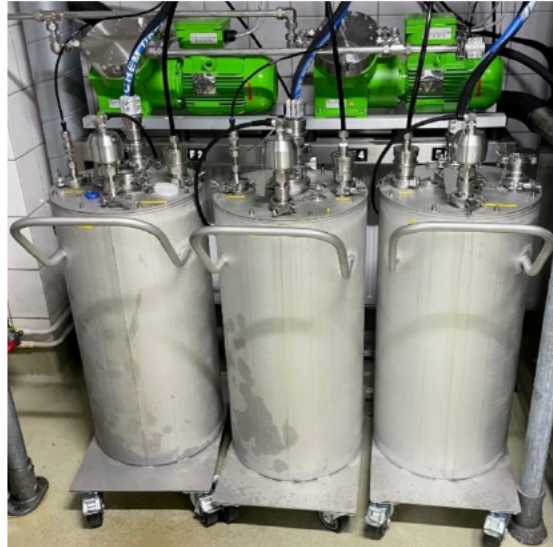
Abbildung 10: Lösemittelbehälter der Fassreinigungsanlage
