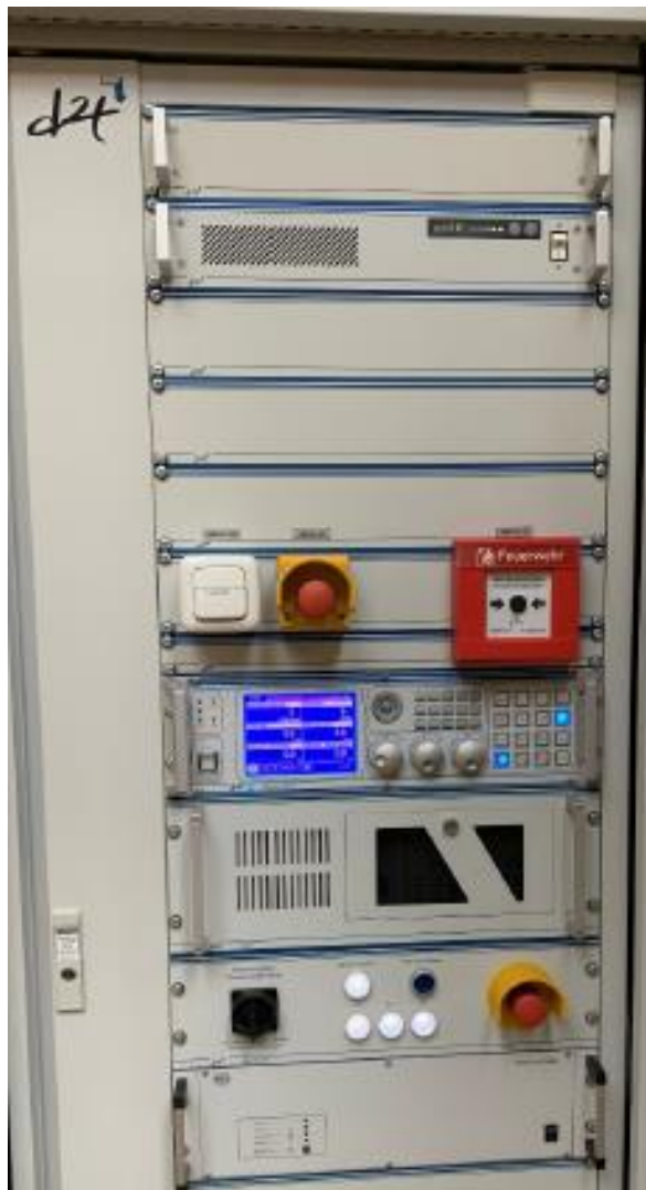
Abbildung 26: Schaltschrank für die Prüfstandssteuerung [35]
