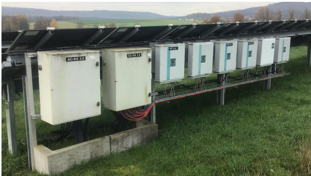
Abbildung 3-4 Beispielhafte Aufnahme einer WR-Bank (Quelle: Anlagendokumentation)
