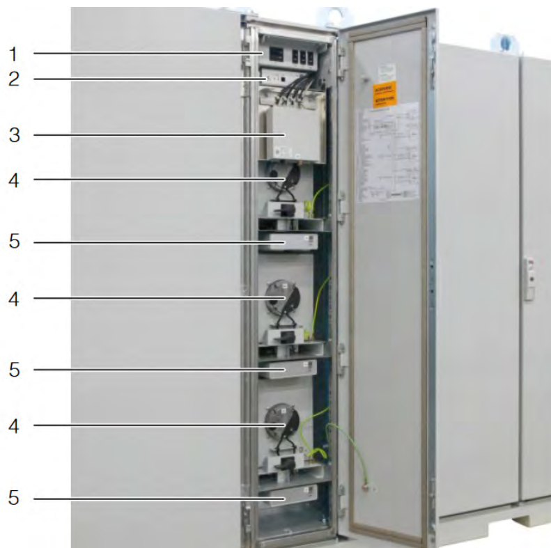
Abbildung 2.6: Aufbau der Schaltschrank-Kühlung mit nummerierten Bauteilen [45]
