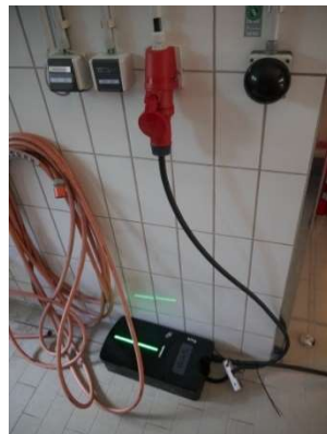
Abbildung 6: installierte Wallbox an NEF-Station
