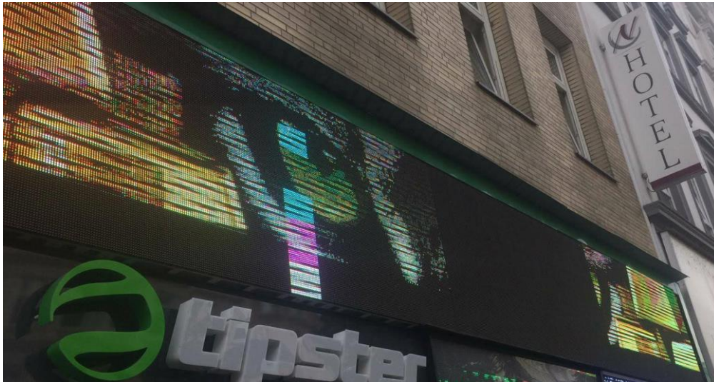
Abbildung 111: Beispiel-Fehlerbild durch defekte ICs (Mitte) und Teilausfall der LED-Geräte (rechts) 193
