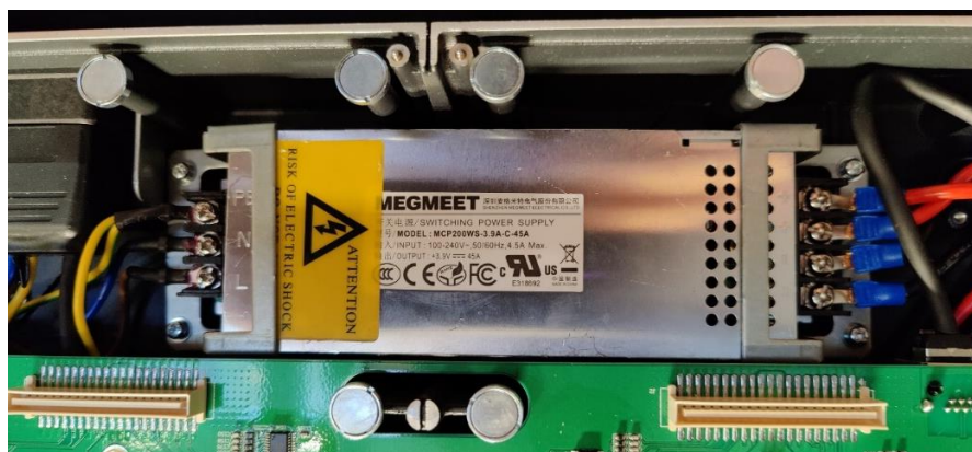
Abbildung 71: Verbaute Power Supply der Marke Megmeet 116
