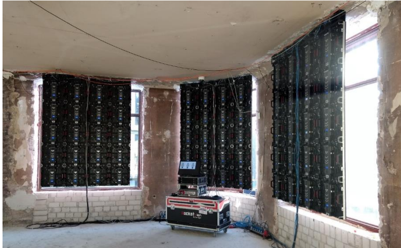
Abbildung 60: An der Decke montierte LED-Installation 101
