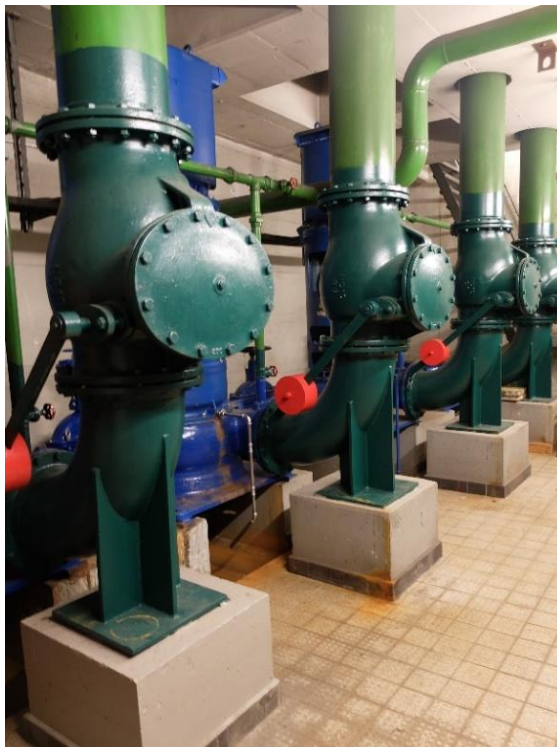
Abbildung 4.2: Trocken aufgestellte Kreiselpumpen unterhalb der Fahrbahn
