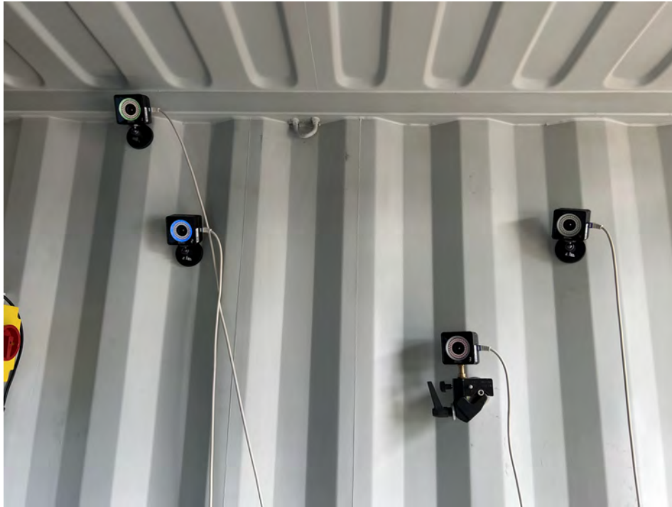
Abbildung 4.1: Das für Ausbaustufe 1 verwendete Array von vier rückwärtigen OptiTrack Prime13 Kameras, magnetisch angebracht an die Innenwände des Testcontainers
