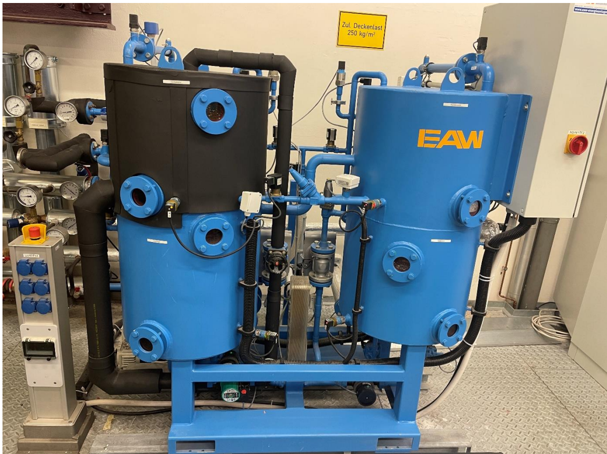
Abbildung 6 Frontalansicht Absorptionskältemaschine Wegracel SE15
