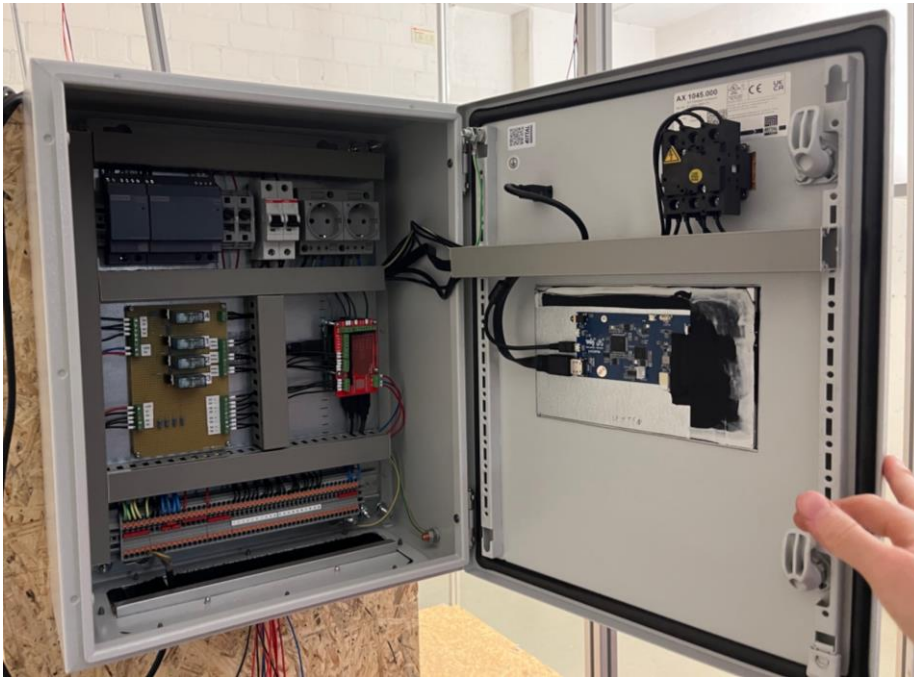
Abbildung 59: Fertiger Schaltschrank (bestückt, verdrahtet & montiert)
