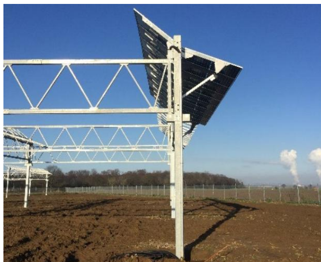
Abbildung 12: Agri-PV-Anlage bei Jülich mit V-Form zur Regenwassersammlung (Meier-Grüll et al. , 2024)
