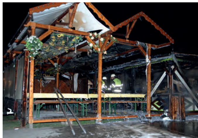
Abb. 36: Durch Brand zerstörter Gastronomiebetrieb
