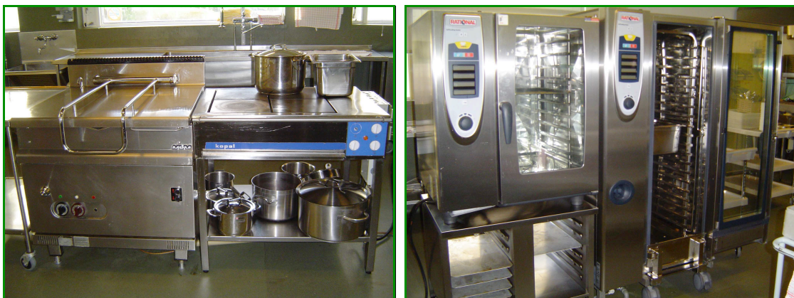
Abb. 10 und 11 Kippbratpfanne und Elektroherd (li.) sowie die neuen Kombidämpfer (re.) in der Küche in Reykjalundur (Fotos: ZSP).
