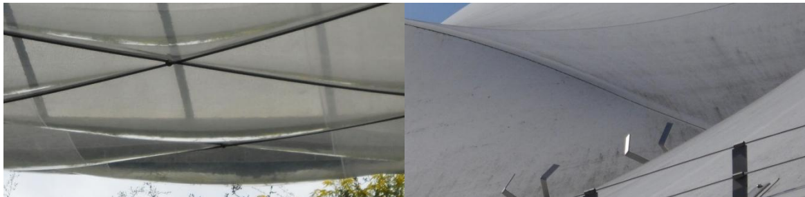
Abb. 24: Verschmutzungsverhalten Links: Alte neben neue ETFE-Folienbahnen; rechts: U-Bf. Fröttmaning
