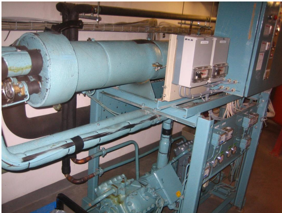
Abbildung 70 Die ältere Kolben-Kompressionskälteanlage, Baujahr 1992, Kühlmittel R 22, Firma Ruhaak-Cliref, Baureihe Drlwy 41, Kälteleistung von 140 KW
