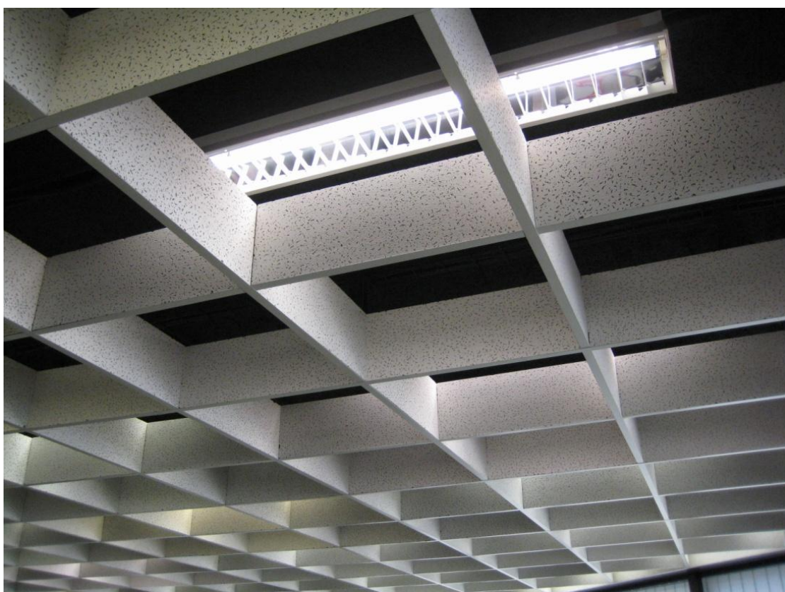
Abbildung 67 Anordnung der Beleuchtung im Großraumbüro BA I
