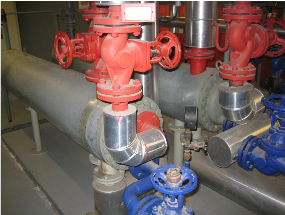
Abbildung 65 Wärmetauscher Übergabe der Fernwärme
