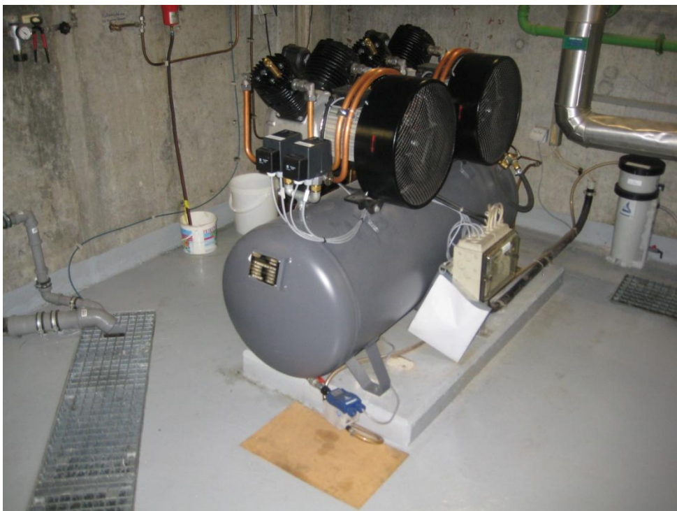
Abbildung 63 Druckluftkompressor 2 x 2,2KW
