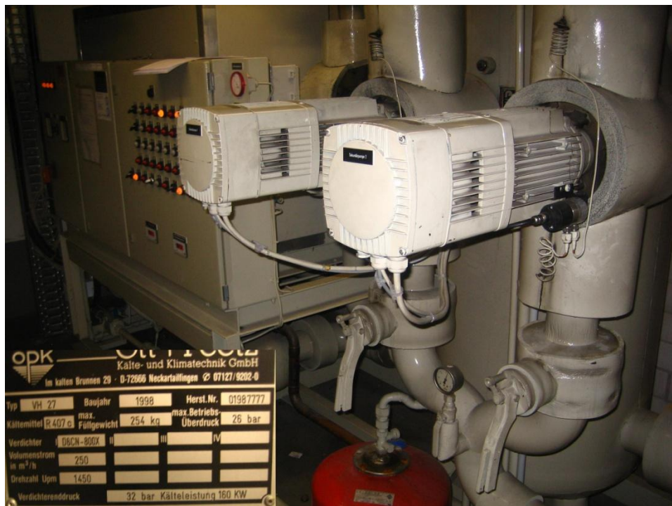
Abbildung 71 Kälteanlage, Schraubenverdichter, Firma Opk Baujahr 1998, Kältemittel R 407c, Kälteleistung 160 kW
