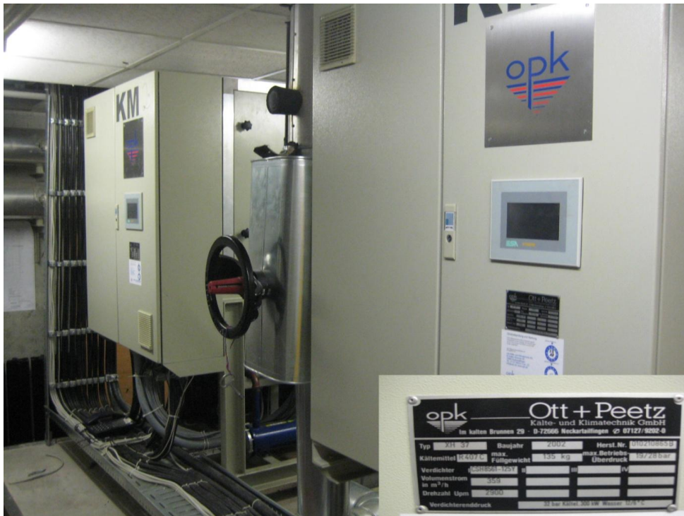
Abbildung 62 Kälteanlage BA I
