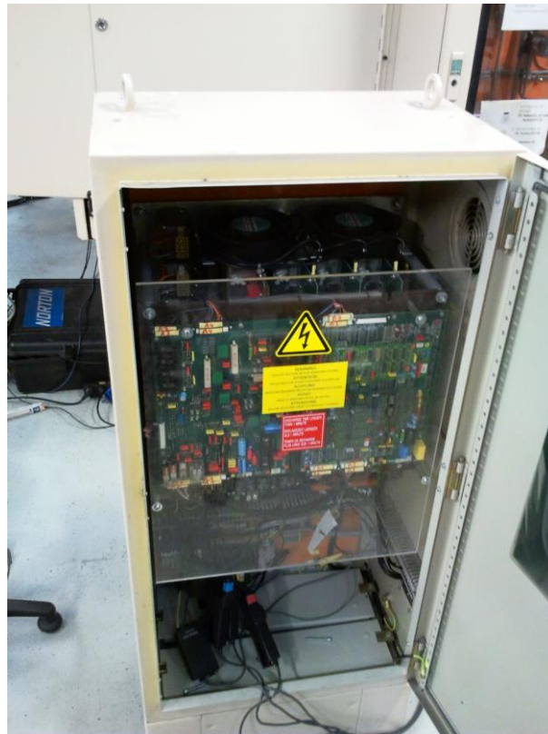
Bild 3.3: Ansicht des geöffneten HF-Umformers (defekte Steuerungselektronik im vorderen Bereich sichtbar)
