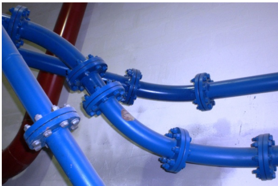
Abbildung 2 – Mehrfacher Rohrbogen in einer Förderleitung - Technikum FLSmidth Hamburg GmbH
