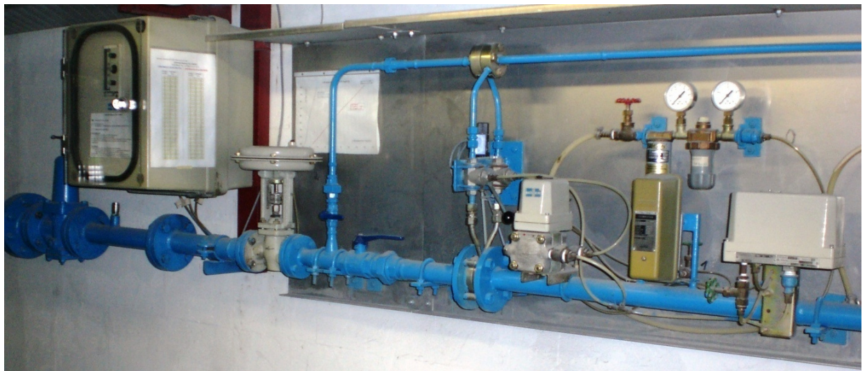
Abbildung 12 — Luftmassenstrom-Regelstrecke — Technikum FLSmidth Hamburg GmbH
