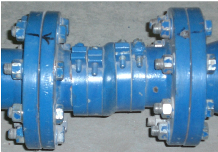
Abbildung 13 – Rohrkompensator hinter der Förderlufringkammer
