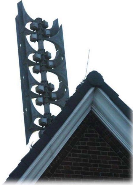
Elektrische - Lautsprechersirene ECN 2400 am Standort: Kirchwerder Hausdeich 341
