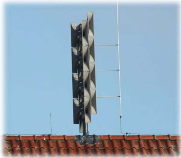
Elektrische – Lautsprecher Sirene ECN 2400 Am Standort: Durchdeich 108
