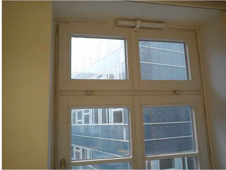
Abbildung 2.1.: Oberlicht mit eingebautem Motor
