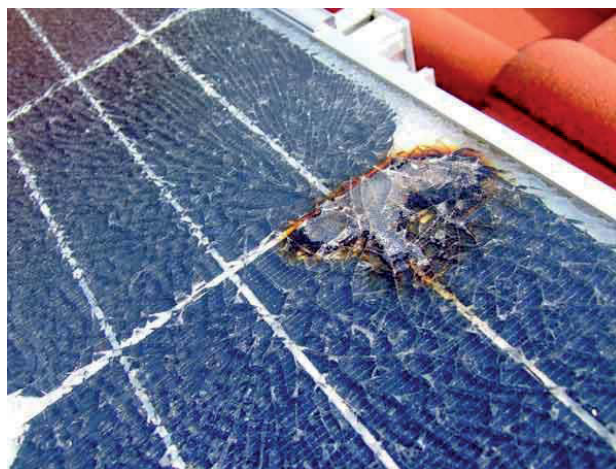
Abb. 2.8: Beschädigung eines Moduls in Folge eines Hot Spots [22]
