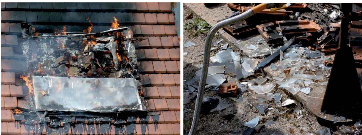
Abb. 2.10: Brand eines Moduls und daraus entstehende Trümmer [12]
