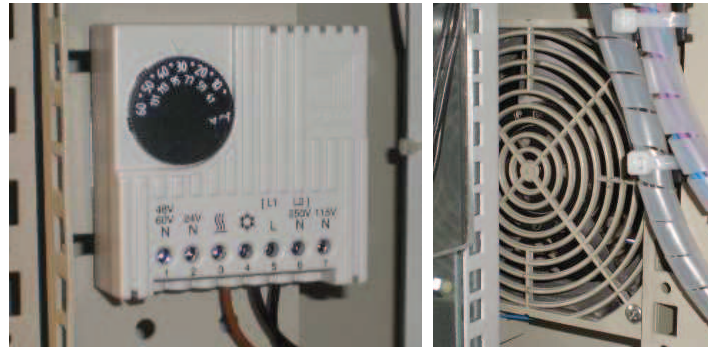
Abbildung 3-71: Temperaturregler und Lüfter im Schaltschrank
