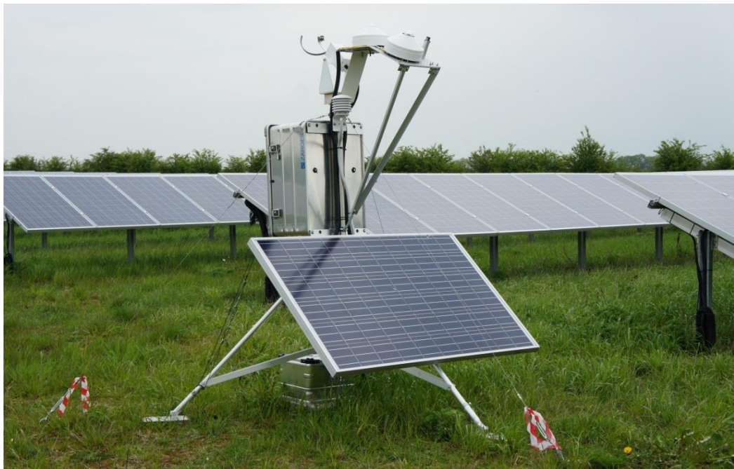
Abbildung 27: Wetterstation im Feldbetrieb
