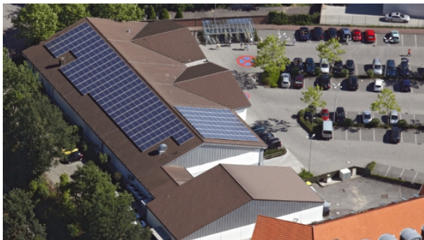
Abbildung 33 – PV-Anlage auf Discounter Photo: photovoltaik.eu [39]
