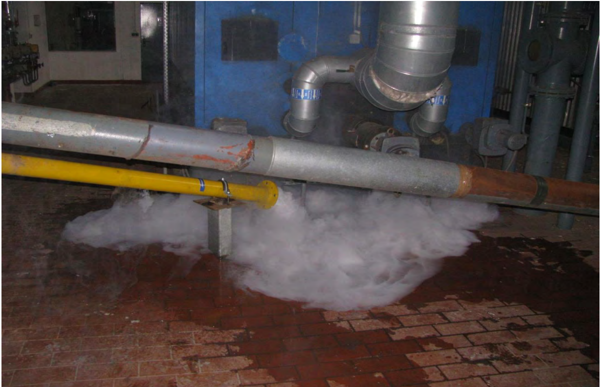
Abb. 17: Darstellung von Ammoniakaustritt mittels eingespeistem Nebelfluid und Wasser in ein Rohrleitungssystem (Quelle: Verfasser)
