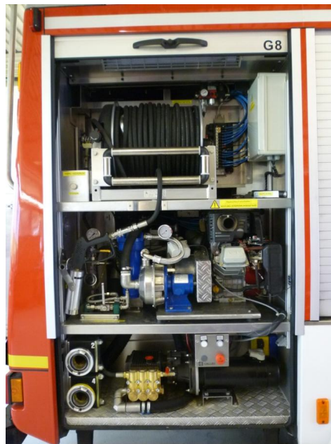
Abbildung 16: Hochdrucklöschanlage der Firma Callis am Standort Schillerhöhe 38
