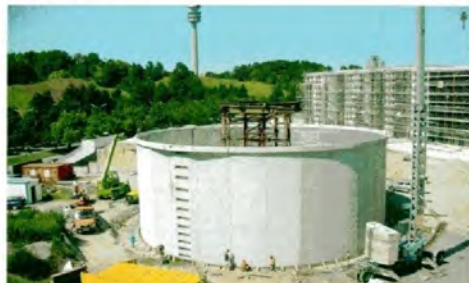
Gegenüberliegend angeordnete Spannrisen, durch die die Spannritzen in die Lehrrohre eingefädelt wurden
