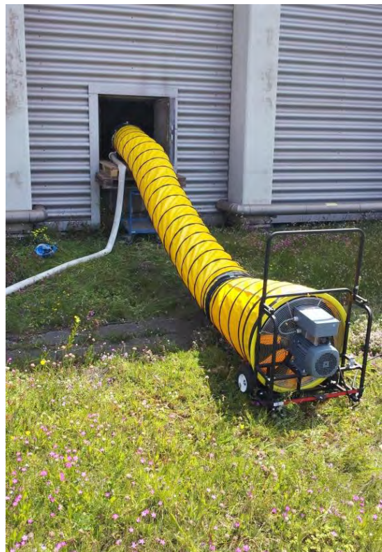
Abbildung 15: Aufbau Lüfter und Schaumgenerator
