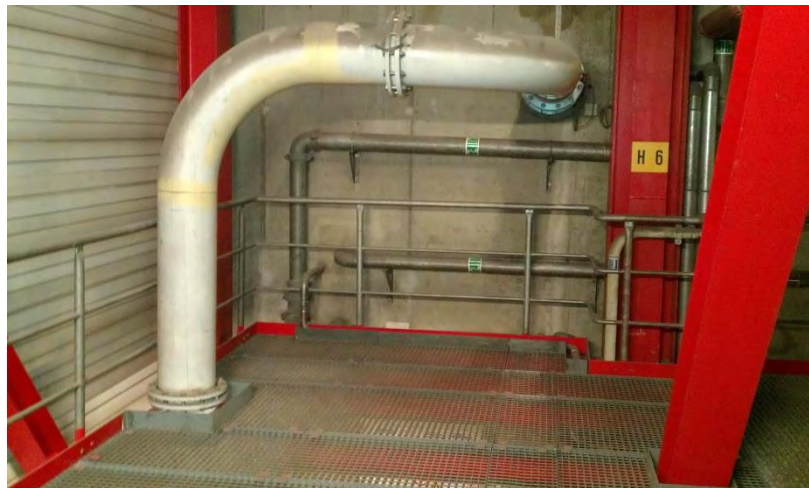
Abbildung 7: Möglicher Aufstellungsort im Kesselhaus
