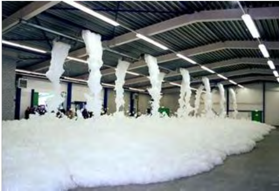
Abbildung 24: Stationäre Leichtschäumlöschanlage (Feuerwehr Grosswetzdorf, 2011)
