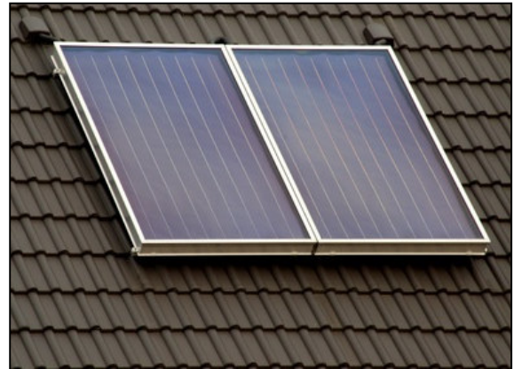
Abbildung 14: Flachkollektor auf einem Dach mit Neigungswinkel
