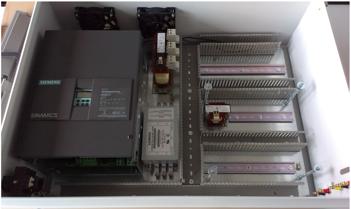
Abbildung 4.12: Mechanisch fertige und teilweise bestückte Montageplatte
