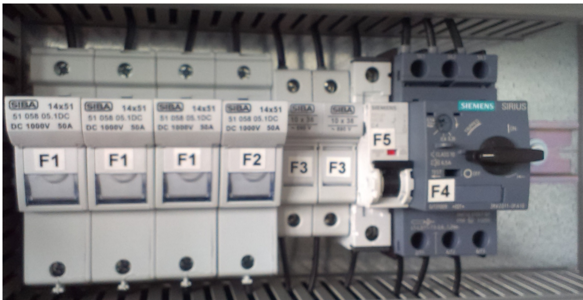
Abbildung 4.5: Sicherungen des Schaltschranks
