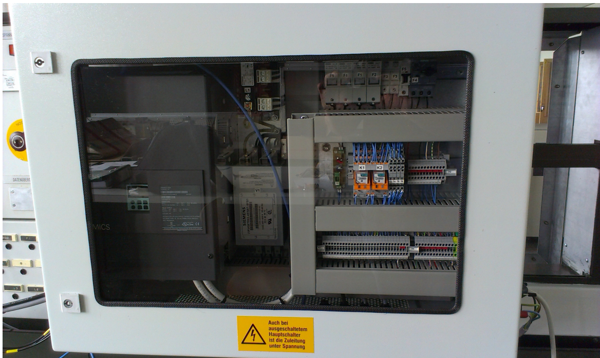
Abbildung 4.20: Front des Schaltschranks
