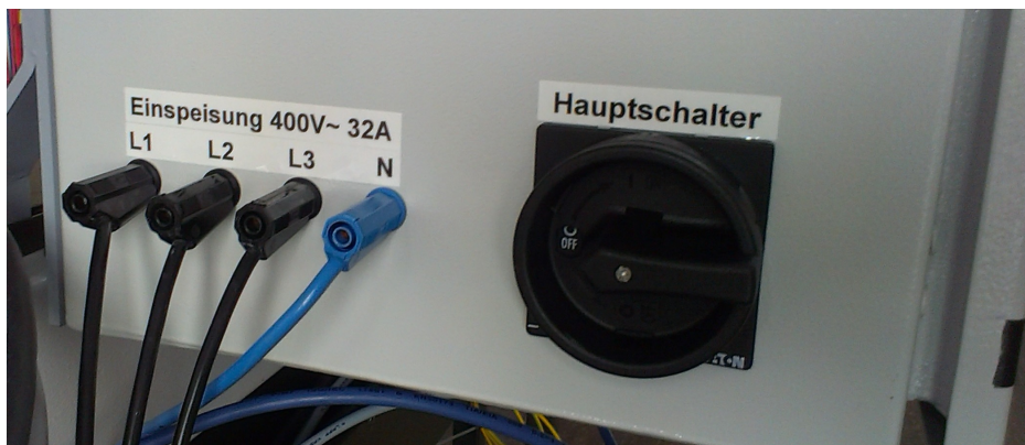
Abbildung 4.18: Anschlussfeld Versorgung an linker Seite des Schrankes
