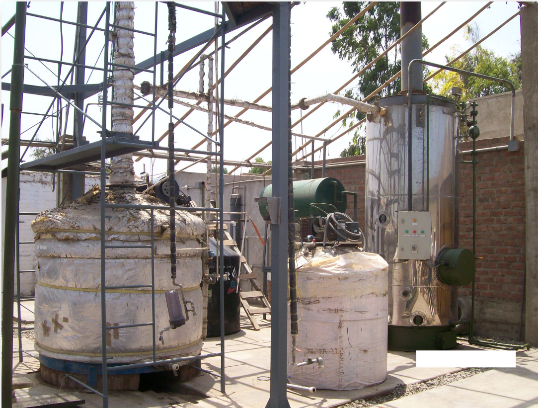
Abbildung 2 - Rektifikationskolonne außer betrieb - Quelle: Eigentümer der Anlage in Peru
