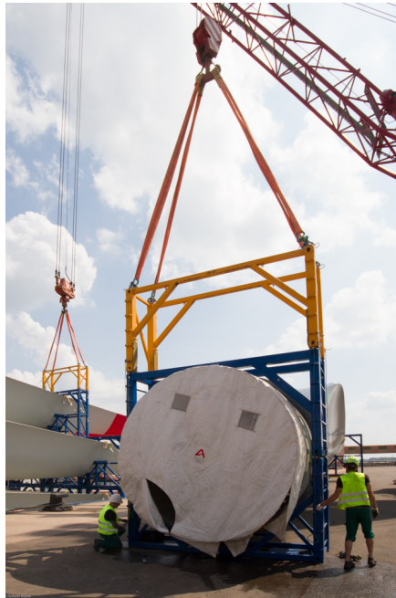
Abbildung 4.7.: Kranhub eines Rotorblattes unter Verwendung eines Gestellteiles als Spreiztraverse für ein Vierlingsgehänge [14]
