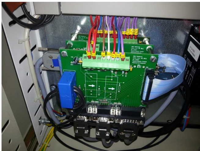
Bild A. 2: Mit der neuen Platine Verteilung im Schaltschrank
