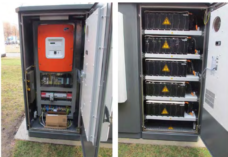
Abb.3-9 Gehäuse des Akkumulators, Links: elektronische Bauteile mit Lade- u. Wechselrichter, Rechts: Akkumulator-zellenblock (Quelle: BBR 2012)
