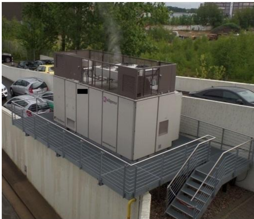
Abbildung 4.1: Brennstoffzellen-Anlage beim Autohaus in Hamburg. Logo des Automobilunternehmens auf Wunsch zensiert (Quelle: eigene Aufnahme vom 14.07.2015)
