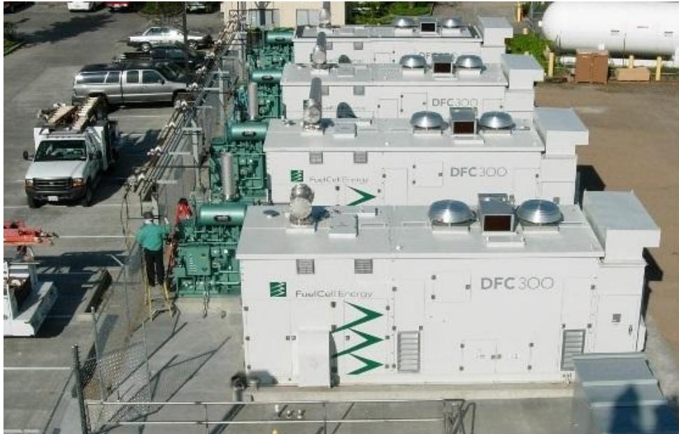
Abbildung 3.5: FuelCell Energy DFC®-Kraftwerk in einer Brauerei (Quelle: www.fces.de )
