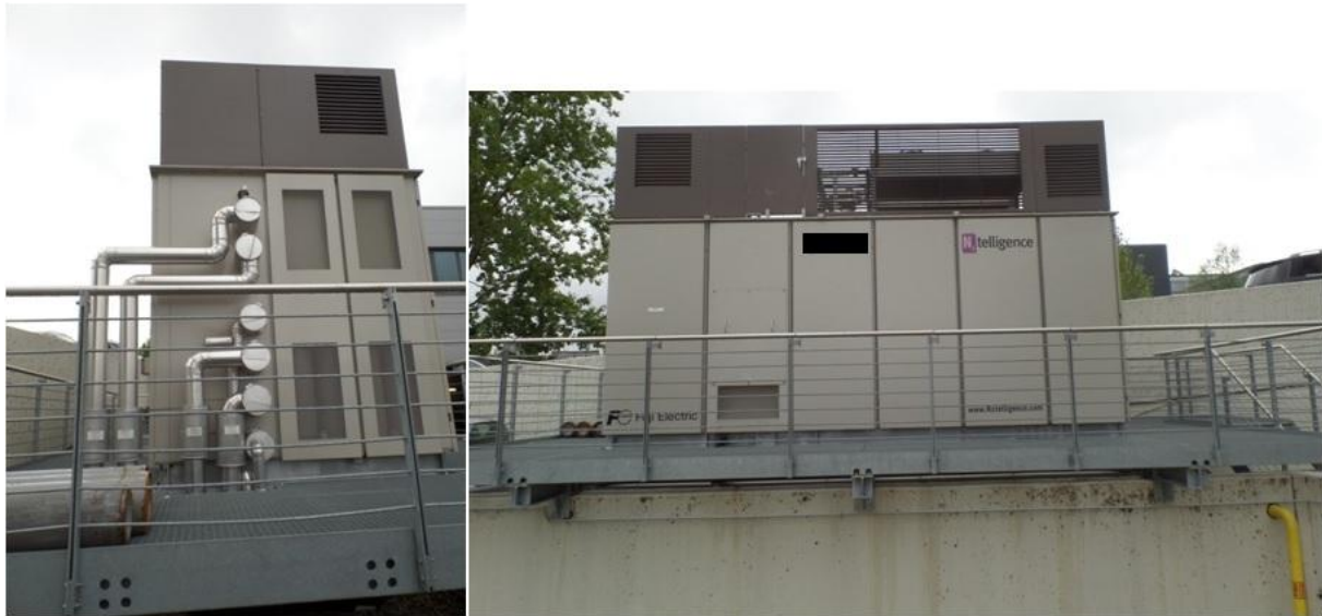
Abbildung 4.2: Brennstoffzellen-Anlage beim Autohaus in Hamburg. Logo des Automobilunternehmens auf Wunsch zensiert (Quelle: eigene Aufnahmen vom 14.07.2015)
