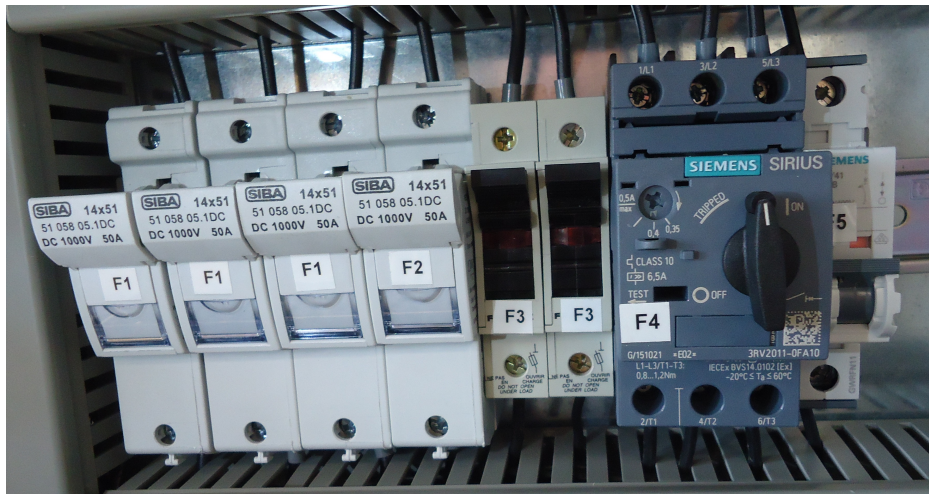
Abbildung 4.3: Verbaute Sicherungen im Schaltschrank
