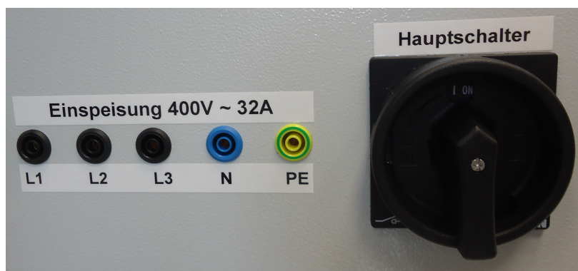
Abbildung 4.11: Einspeisung und Hauptschalter
