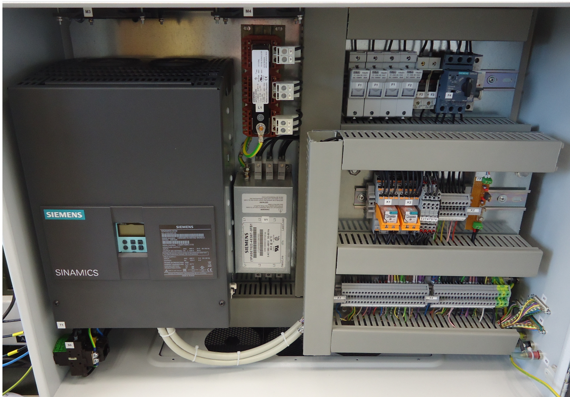
Abbildung 4.13: Blick in den fertig verdrahteten Schaltschrank
