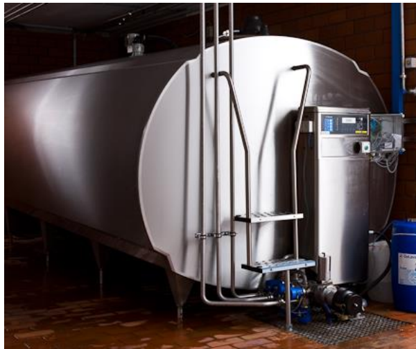
Abbildung 4: Milchtank mit direkter Kühlung durch Kälteaggregat (DeLaval)
