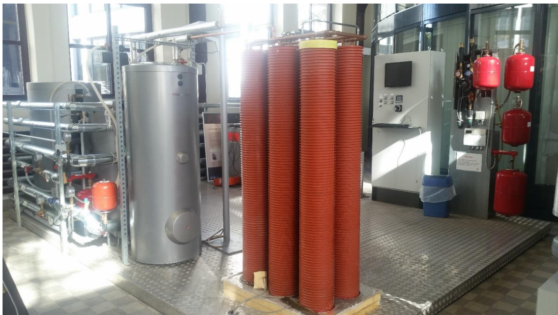
Abbildung 6: Der Latentwärmespeicher vor der Ausarbeitung
