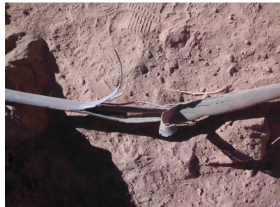
Abb. 31: Durch Tiere zerstörte Leitungssysteme [Falk]
