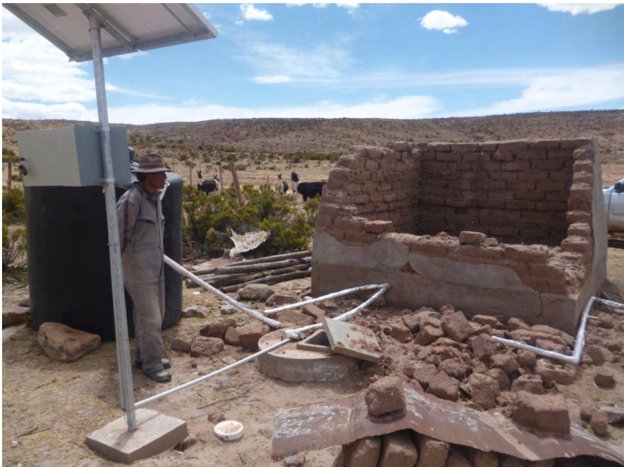
Abb. 22: Durch mangelhafte Bauweise eingestürzter Sockel [Energética]
