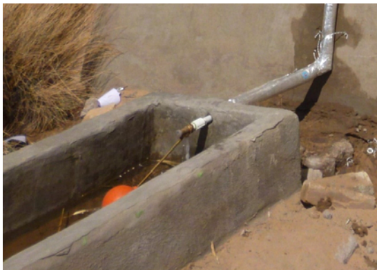
Abb. 30: Wasserhahn zur Befüllung der Tränke [Energética]
