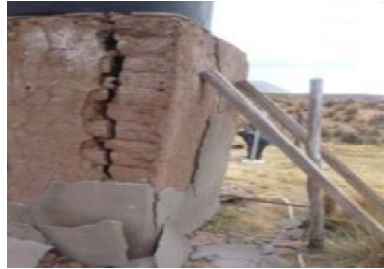
Abb. 24: Stark einsturzgefährdeter Sockel [Energética]
