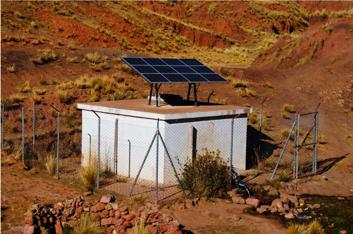
Abb. 1: Solares Wasserpumpensystem im Norden Potosis
