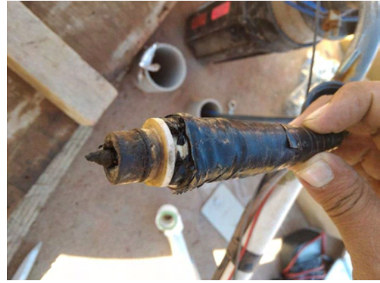
Abb. 19: Durch Wassereintritt beschädigte elektrische Verbindung [Energética]
