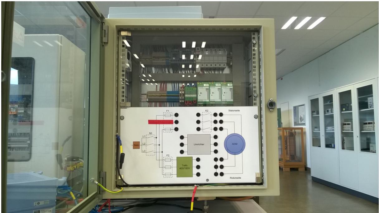
Abbildung 10: Umrichterschaltschrank der ASM mit Stecktafel des Versuchsstands „Windenergie-Netzeinspeisung“
