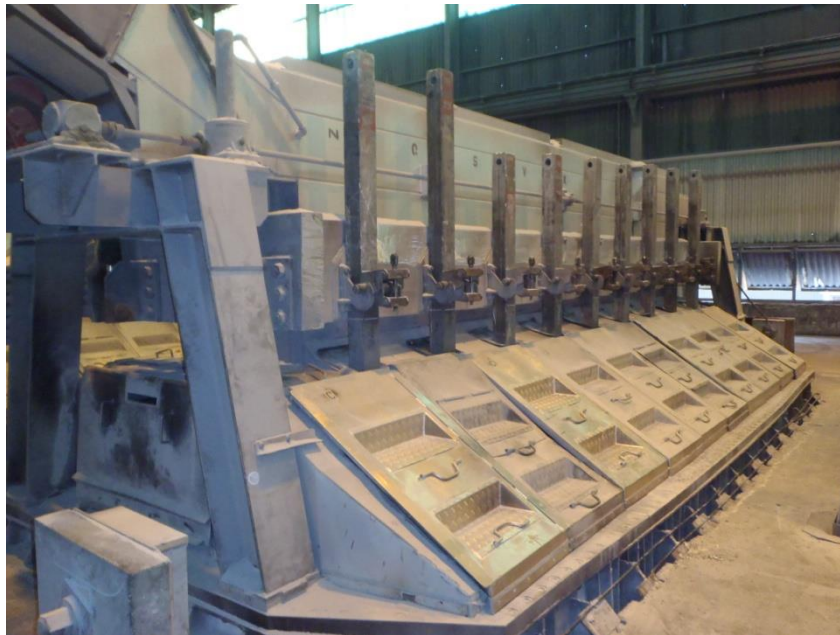
Abbildung 2: Elektrolyseofen 172 am Standort Hamburg [4]
