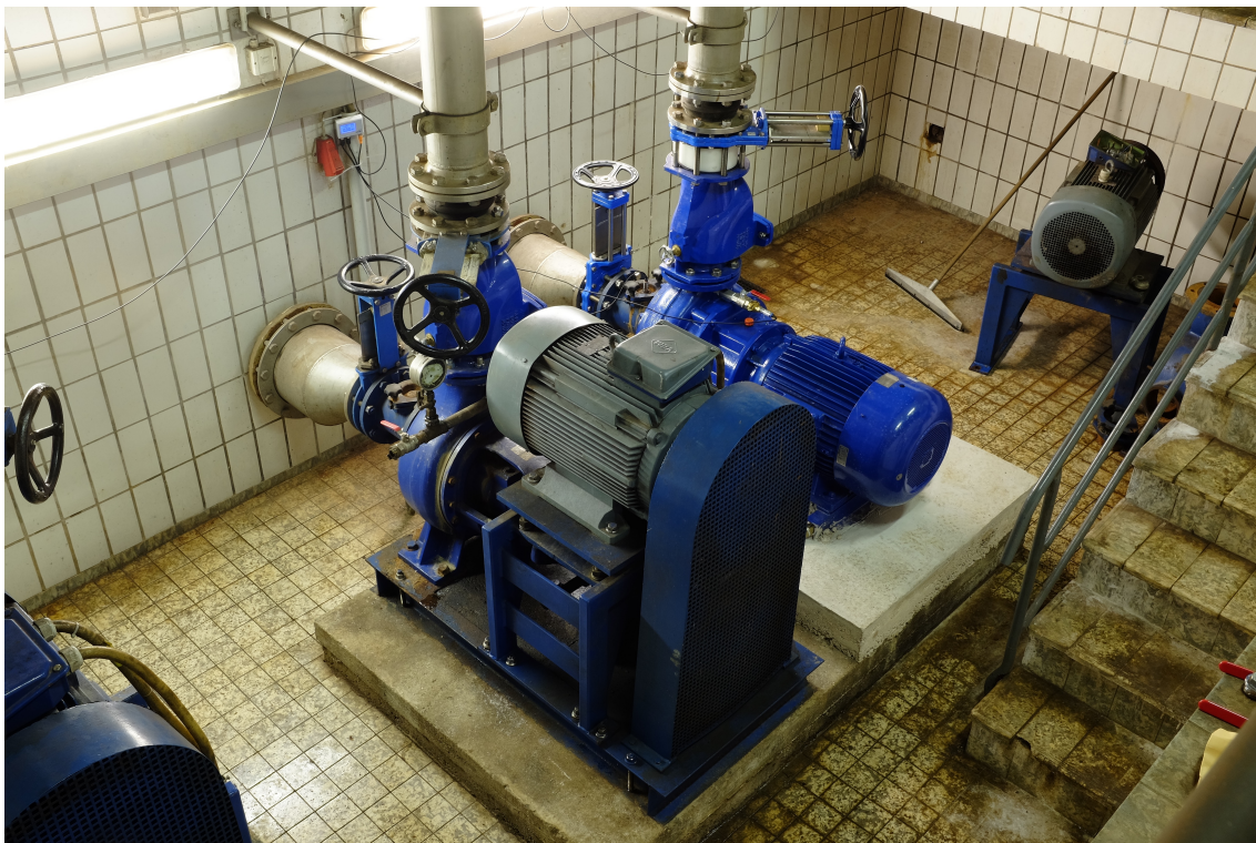
Abb. F Blick in das Pumpwerk: Die ältere Pumpe (links) und neuere Pumpe (rechts).
