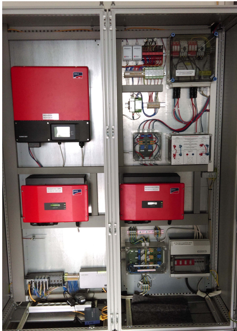
Abbildung 5.4.: Schaltschrank inklusive Messtechnik im Raum 15.80
