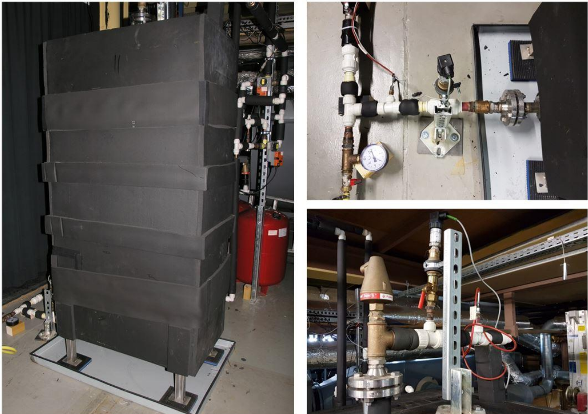
Abbildung 3.2: Darstellung des Speichertanks und der Anschlüsse mit installierter Messtechnik
