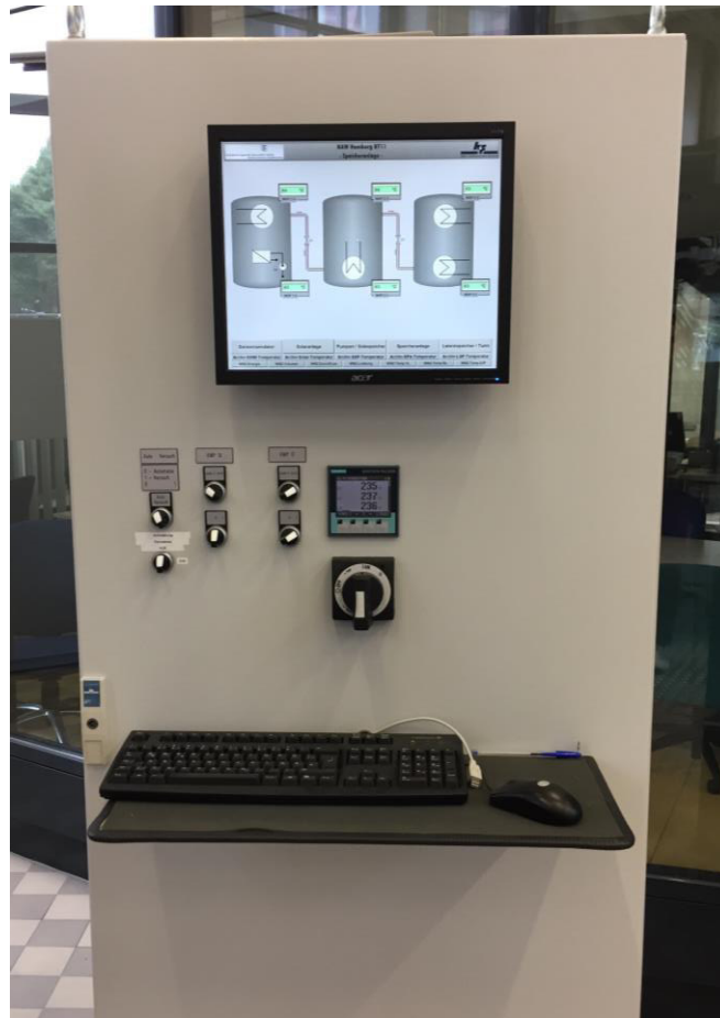
Abbildung 2: Schaltzentrale zur Steuerung und Überwachung
