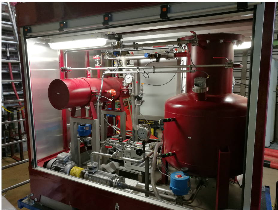
Abbildung 3.1.: Bild der Ölaufbereitungsanlage (Quelle: eigenes Foto)
