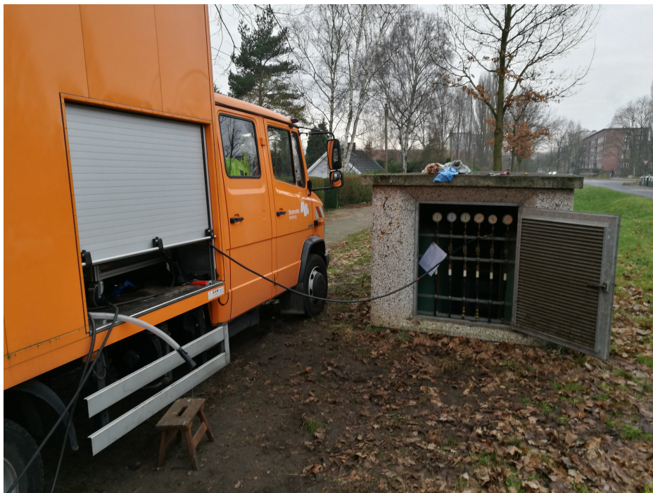
Abbildung 5.8.: ÖAG-Messung an der ÜNS Süderstraße (Quelle: eigenes Foto)
