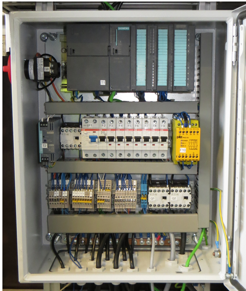
Abbildung 3.3.: Bild des Schaltschranks (Stand bei Abgabe dieser Arbeit) (Quelle: eigenes Foto)
