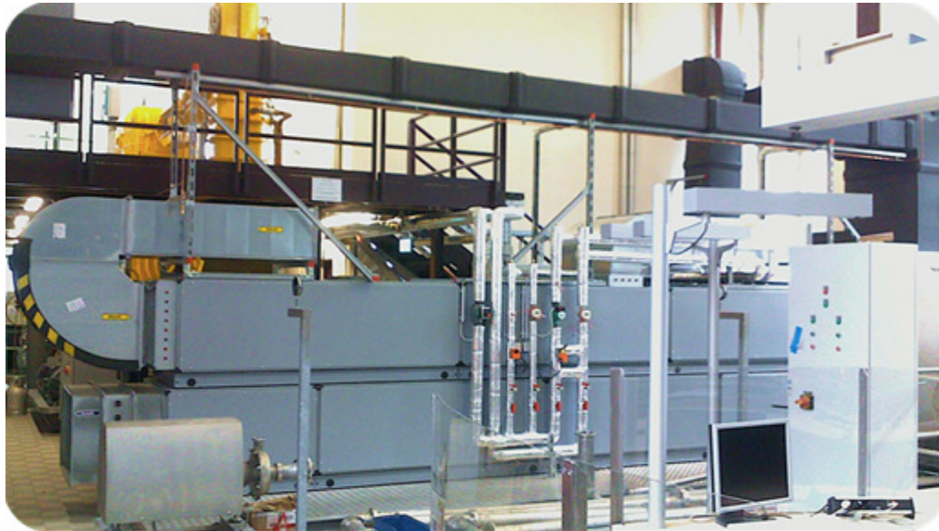
Abbildung 12 – Vollklimaanlage der HAW Hamburg [19]
