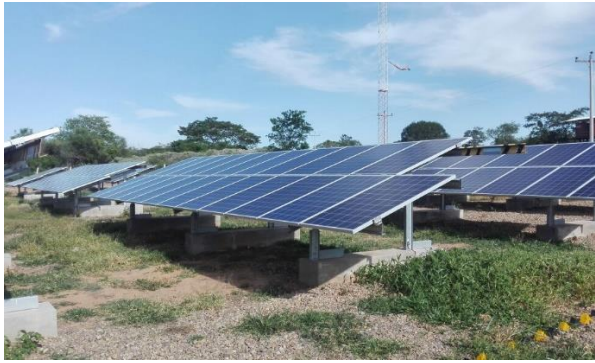
Abbildung 2.11 Photovoltaik-Generator des Hybridkraftwerkes in der Gemeinde El Espino
