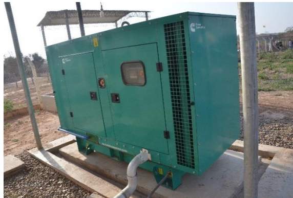
Abbildung 2.14 Diesel-Generator des Hybridkraftwerkes in der Gemeinde El Espino
