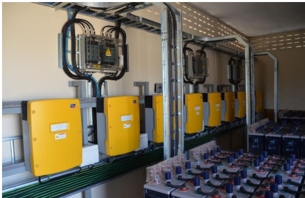
Abbildung 2.13 Batteriespeicher und Batterie-Wechselrichter des Hybridkraftwerkes in der Gemeinde El Espino
