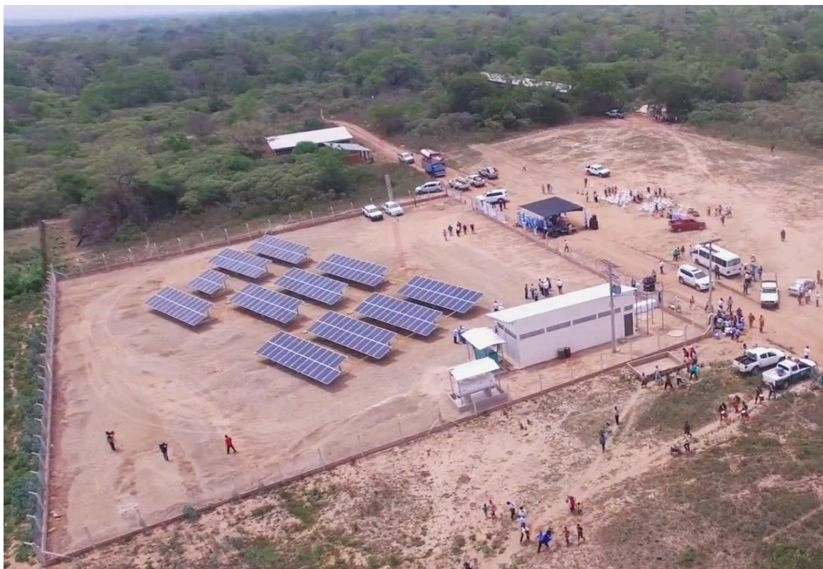
Abbildung 1.1 Photovoltaik-Diesel-Hybridanlage mit einem Batteriespeicher in der Gemeinde San Isidro del Espino – Santa Cruz – Bolivien kurz nach der Fertigstellung im Jahr 2015 (Lorberg 2016)
