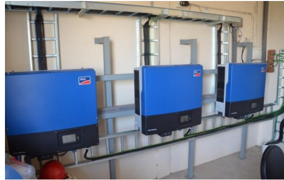
Abbildung 2.12 Strang-Wechselrichter des Hybridkraftwerkes in der Gemeinde El Espino
